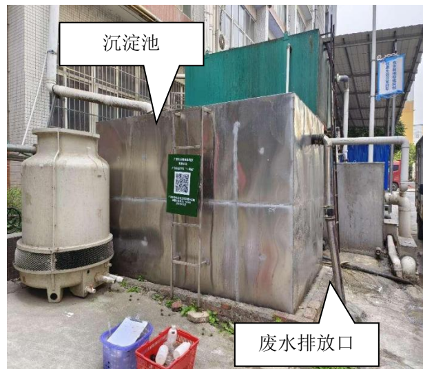
沉淀池及废水排放口
