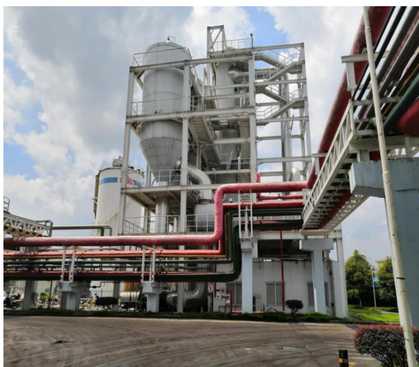
新增的 MVR 系统
