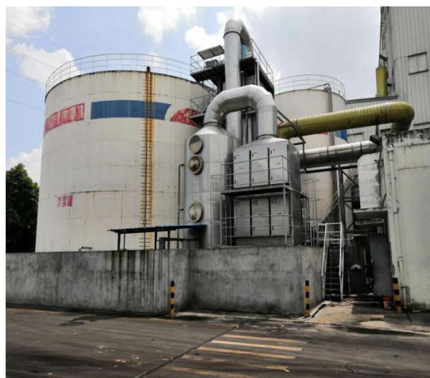
酵母浓缩液储存罐
